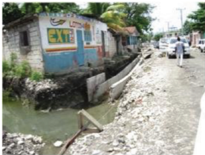
Figure 1 Rues et infrastructures détruites à Léogâne à la suite des inondations en 2012
