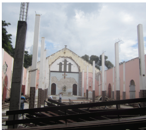
Figure 10 Église La Chandeleur de Gros Morne endommagée par le séisme du 6 octobre 2018 (étiquetée rouge par les TPTC)
