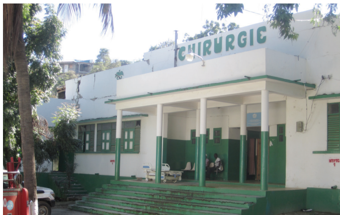
Figure 9 Hôpital Immaculée de Port-de-Paix. Pavillon chirurgie endommagé par le séisme du 6 octobre 2018 (étiqueté rouge par les TPTC)
